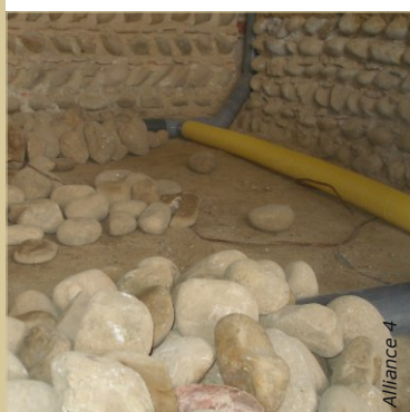
La sortie d'air remonte dans le soubassement. Les entrées et sorties sont en tuyaux pleins.
