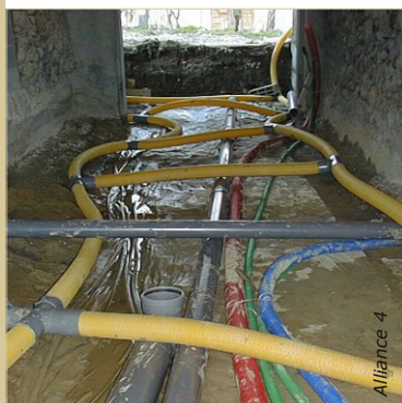
Mise en place du réseau de drain d'air (en jaune). Les autres canalisations de l'habitation passent également dans le hérisson.
