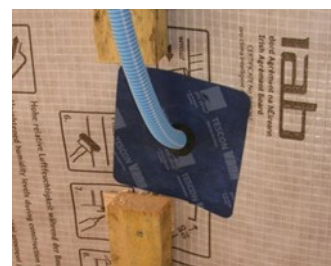
Traversée de gaine électrique
