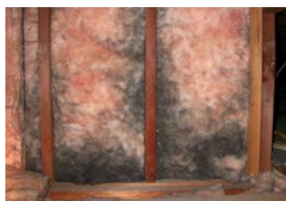
Isolant dégradé par l'humidité
