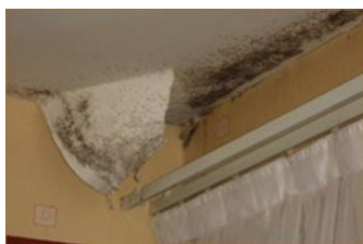
Moisissures au plafond
